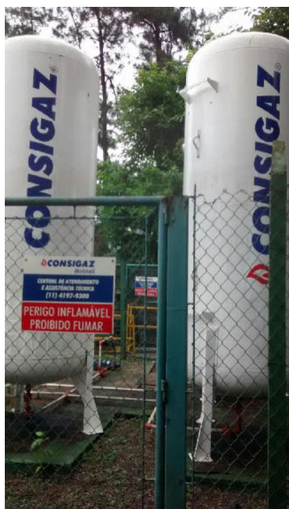
Figura 27: Central de Gás
