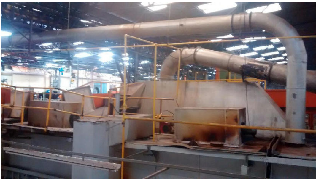
Figura 30: Tubulação sobre estufa continua
